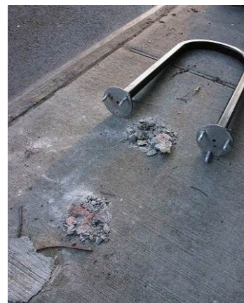
Slika 107: Poškodbe kolesarskih stojal in odpravljanje posledic vandalizma sodijo med tekoče vzdrževanje (Vir: StretBlog NYC)
