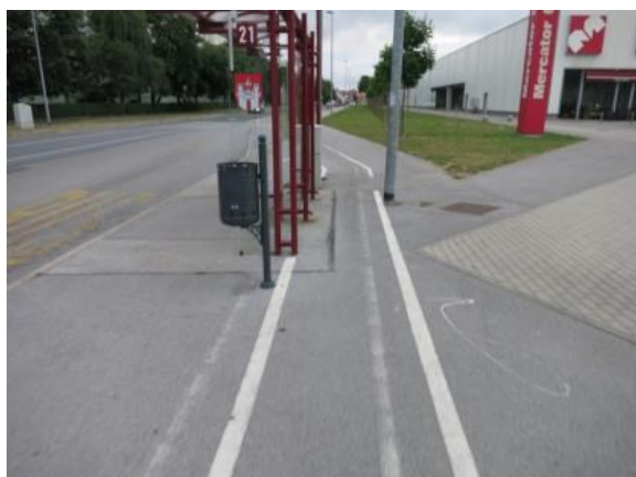
Slika 30: Primer neustreznega vodenja kolesarske steze za avtobusnim postajališčem - premajhni odmiki od ovir (nadstrešnica, drog javne razsvetljave)
