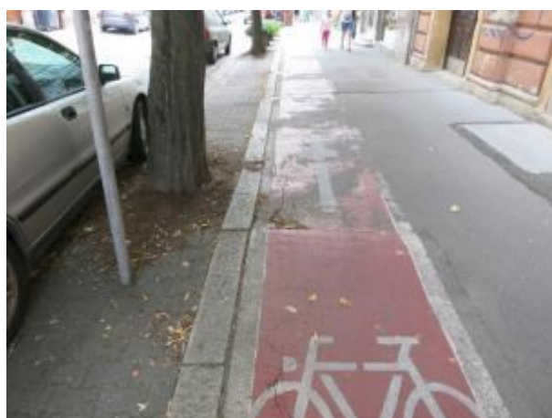
Slika 100: Primer poškodb zgornjega ustroja na kolesarskih povezavah
