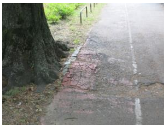
Slika 99: Primer poškodb zgornjega ustroja in obledele rdeče obarvane prevleke
