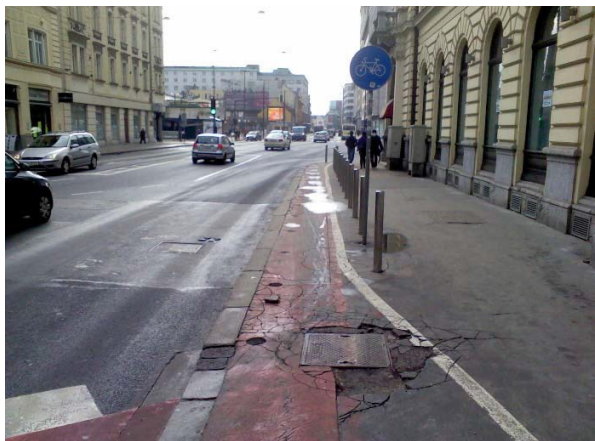
Slika 98: Primeri poškodb zgornjega ustroja na kolesarskih povezavah
