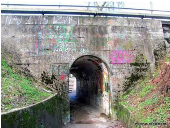
Slika 27: Primer neosvetljenega in ozkega podvoza pod železniško progo, ki ga uporabljajo tudi pešci
